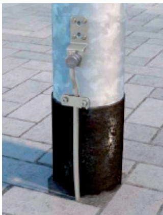
Puesta a tierra en mástil de luminarias, por ejemplo, clase de iluminación CE5
