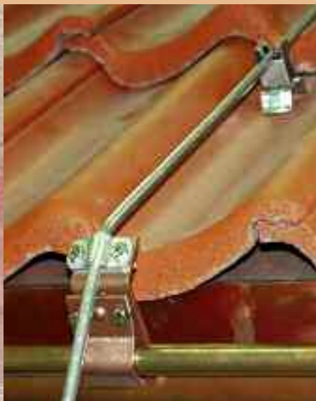
Instalación correcta con conectores bimetalicos (aluminio/cobre)
