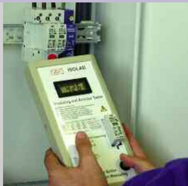
Medición de descargadores de sobretensiones
