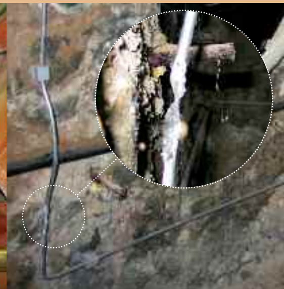
Instalación incorrecta Conductor de aluminio corroído por colocación abierta en la pared
