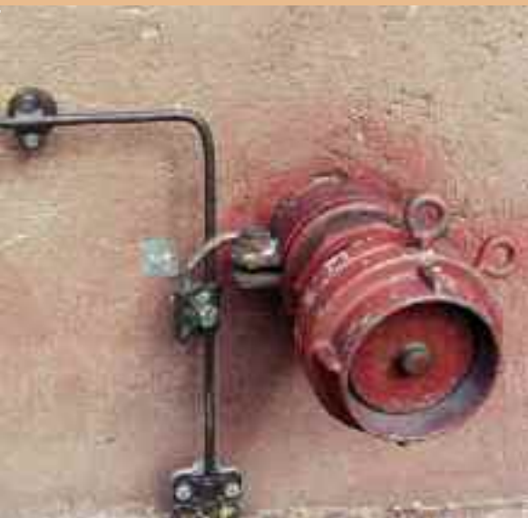
Instalación incorrecta Conexión corroída por el uso de materiales diferentes
